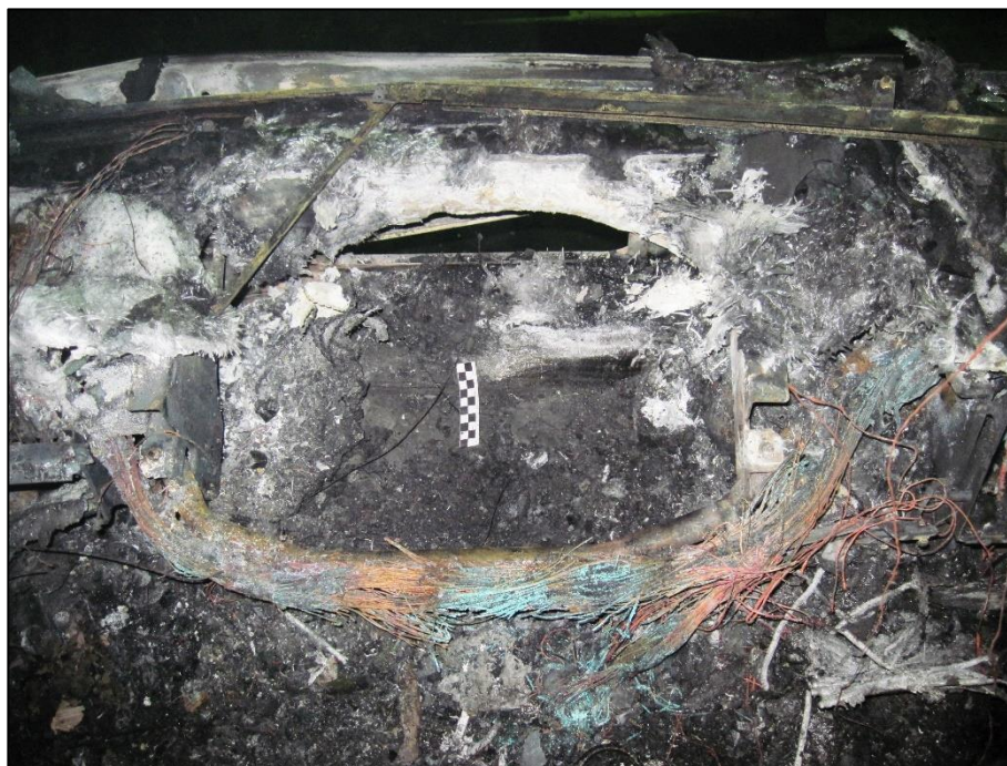
Рис. 2. Вид центральной части панели приборов после пожара.
