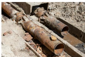
Рис. 1. Изношенность водопроводных труб
