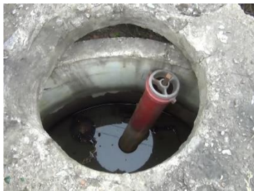
Рис. 2. Неисправность пожарного гидранта
