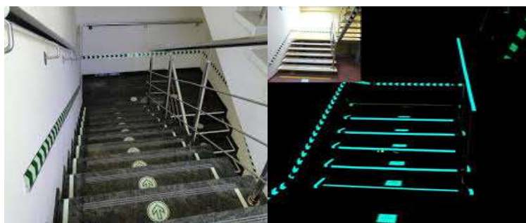
Рис. 3. Применение люминесцентной краски для нанесения разметки на путях эвакуации
